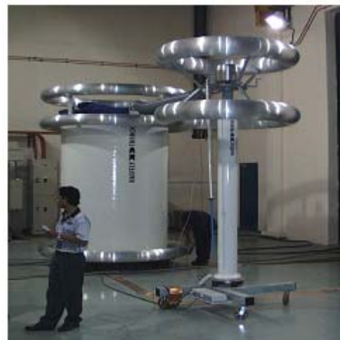
系统中的 300kV 试验变压器和高压分压器
