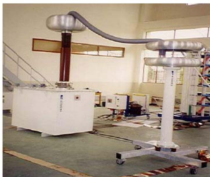
250kV, 50kVA测试变压器和高压分压器
