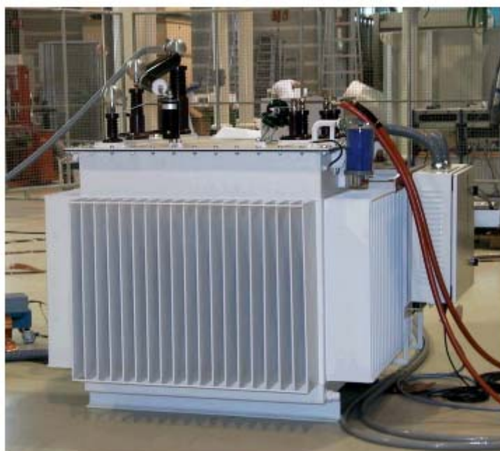
50kV, 400kVA测试变压器
