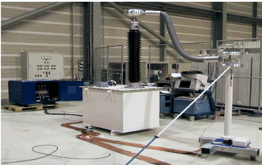
150kV, 70kVA测试系统
