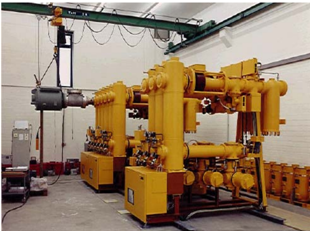
装在 GIS 中的 510TES 测试变压器
